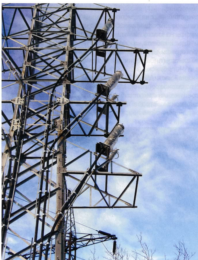
Рис. 9. Концевые муфты МКВ 126 и кабели, закреплённые на опоре ВЛ
