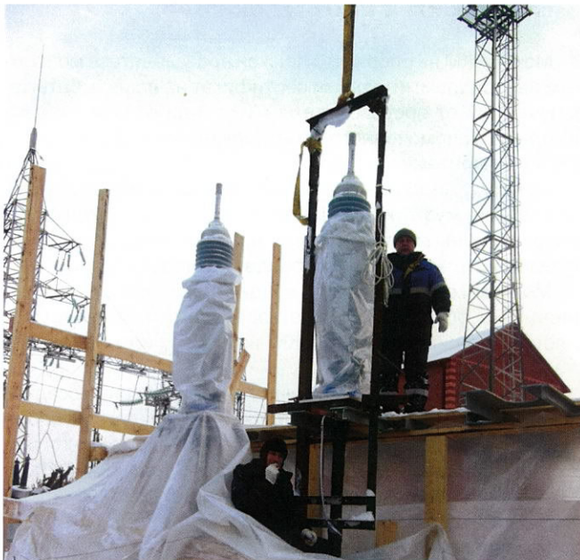
Рис. 1. Концевая муфта ОТС-123 с выводом ОВ перед подъемом на опору ВЛ
