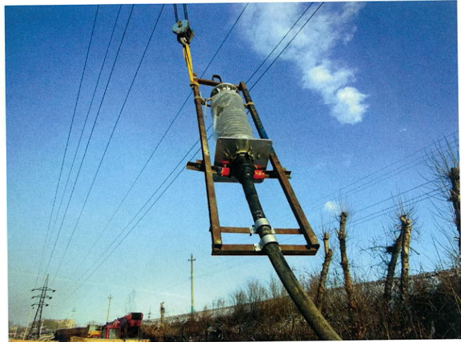
Рис. 6. Крепление МКВ 126 и кабеля на приспособлении, соединении приспособления с крюком подъемного крана с помощью стропа
