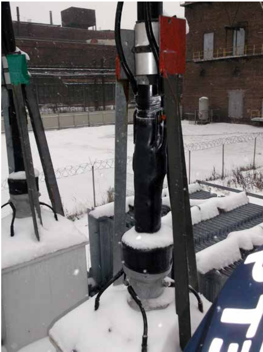
Рис. 25. Герметизированный вывод экрана кабеля 110 кВ из трансформаторного ввода Соппех 5-S (Колпино, 2014 г.)
