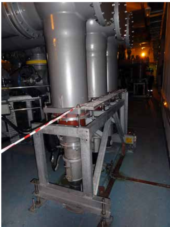
Рис. 15. КРУЭ 110 кВ фирмы ALSTOM на ПС «Чагино» со смонтированными маслонаполненными элегазовыми вводами типа EHS(D)V 123 фирмы Sudkabel
