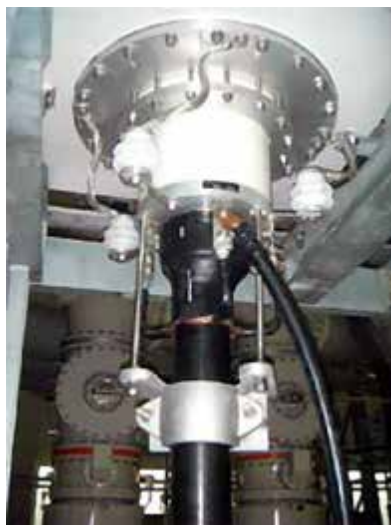
Рис. 14. Элегазовые вводы EHSVS 362-550 компании Südkabel GmbH со смонтированными ВЧ-заземлениями с ОПН вч. Вариант с креплением ОПН вч на ВЧ-заземлениях на планках, закреплённых на фланце поджимного кожуха
