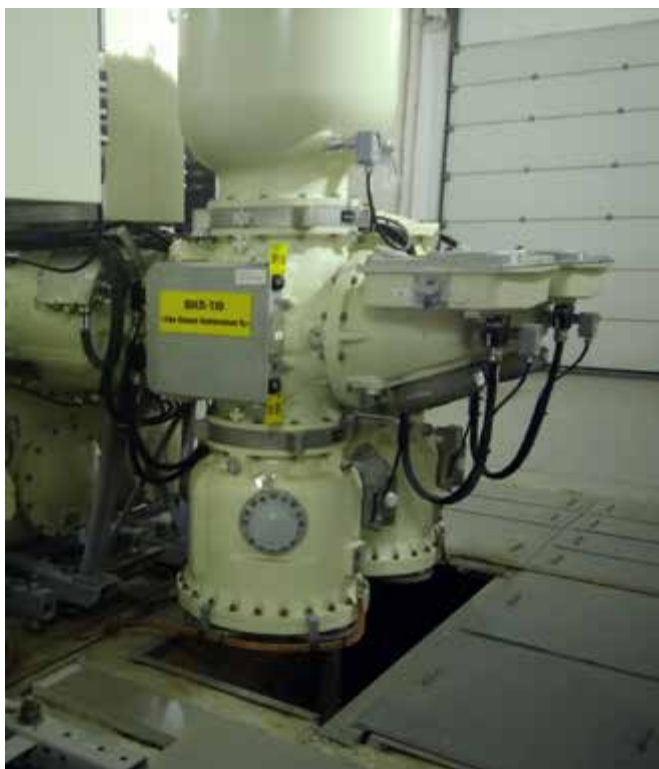
Рис. 17. Заземление корпусов кабельных модулей КРУЭ 145 кВ фирмы Siemens AG типа 8DN8, смонтированных в 2019 г. на ПС «Кустаревская» в г. Уфе
