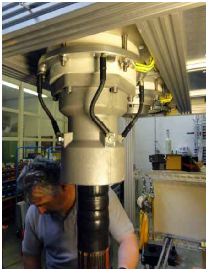
Рис. 12. ВЧ-заземления без ОПН на кабельном вводе Sonnex 6-S фирмы Pfisterer (входят в комплект поставки)
