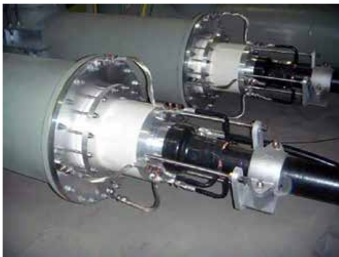
Рис. 9. Элегазовые вводы EHSVVS 245 E с ВЧ-заземлениями из медного провода без ОПН и с непосредственным заземлением вывода экрана кабеля на контур заземления
