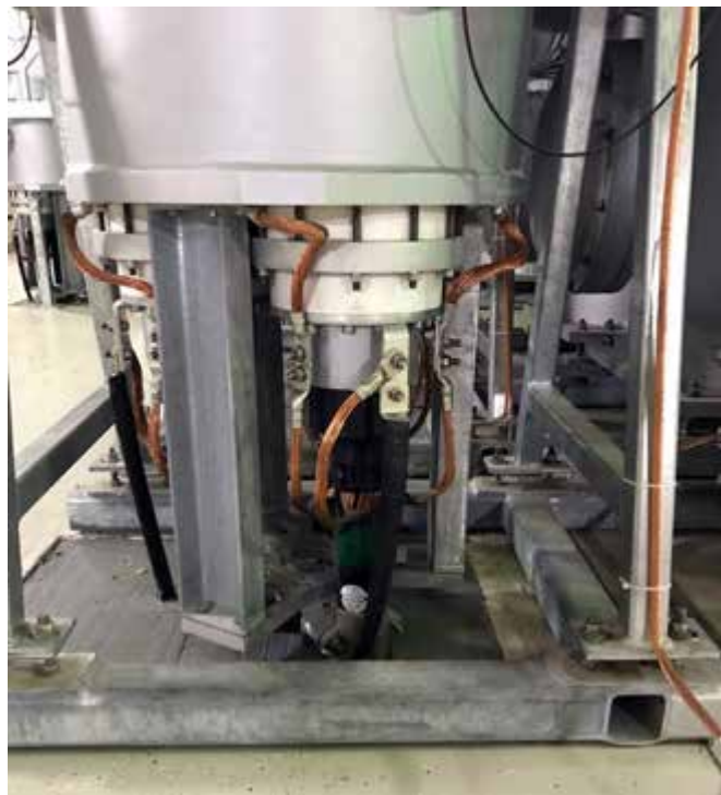
Рис. 8. Элегазовые вводы EHSVS 145 А, смонтированные на трехфазном кабельном модуле КРУЭ фирмы «ABB» типа ELK-04 старой конструкции
