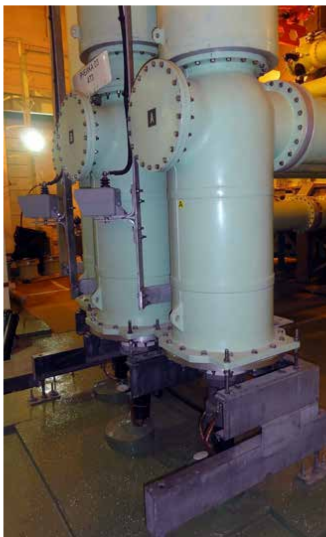
Рис. 16. КРУЭ 220 кВ фирмы ALSTOM на ПС «Чагино» со смонтированными элегазовыми вводами типа Conplex 6-S старой конструкции (без ВЧ-заземлений)
