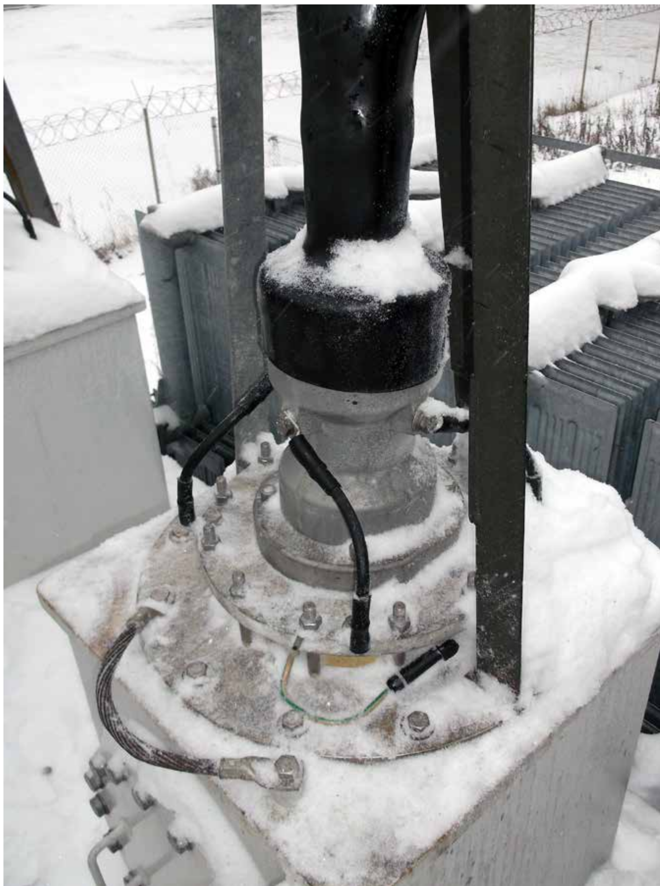
Рис. 26. Заземляющие перемычки на трансформаторном вводе Соптех 5-S, закрепленном на фланце кабельного отсека трансформатора (Колпино, 2014 г.)
